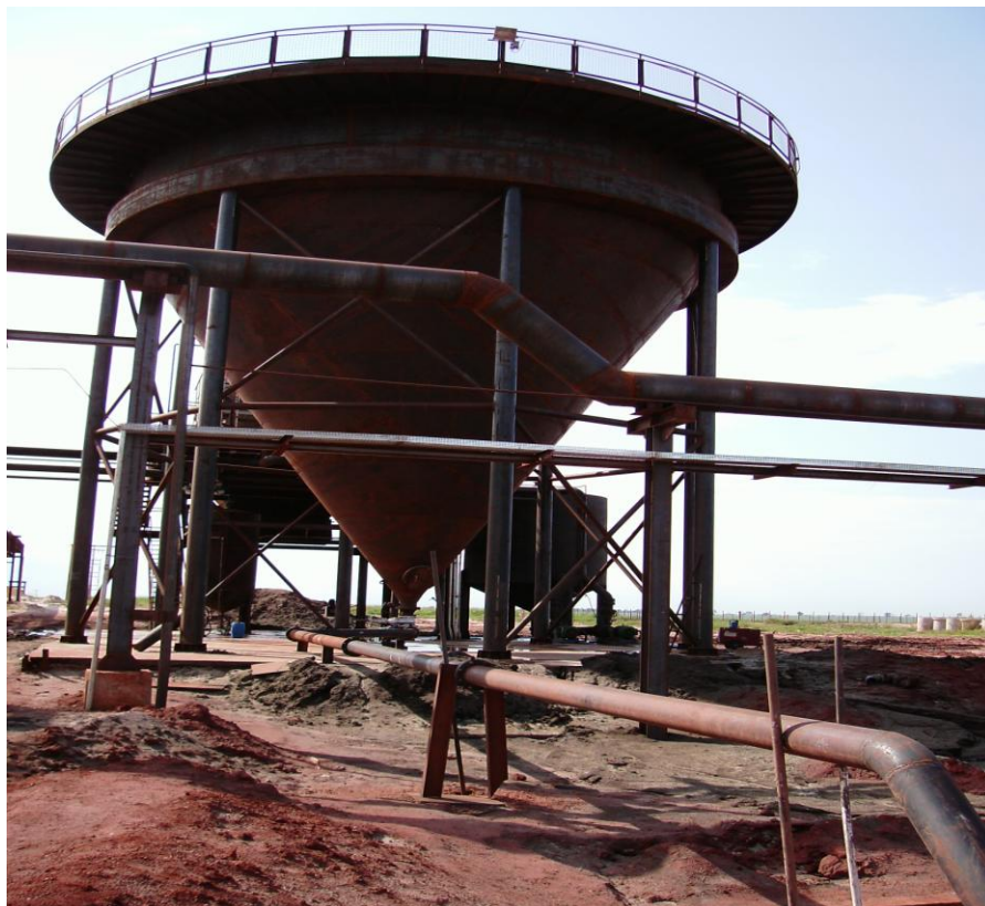
Decantador da torta de filtro
