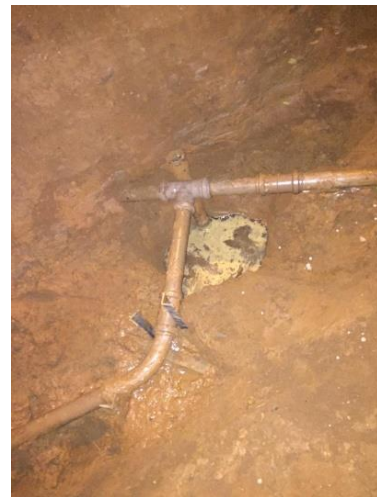
Figura 47 - Rede conforme previsto em projeto para a intervenção 01 no setor 15 – São Marcos
