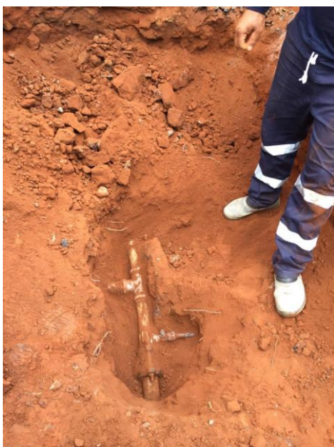
Figura 24 - Situação das redes encontradas, diferente do projeto da intervenção 04 no setor 13 – Filtro Velho
