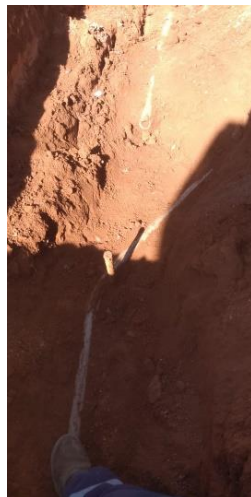
Figura 46 - Situação da rede idêntica ao projeto da intervenção 01 no setor 15 – São Marcos
