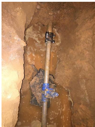
Figura 48 – Válvula (registro de manobra) instalado no limite da intervenção 01 no setor 15 – São Marcos
