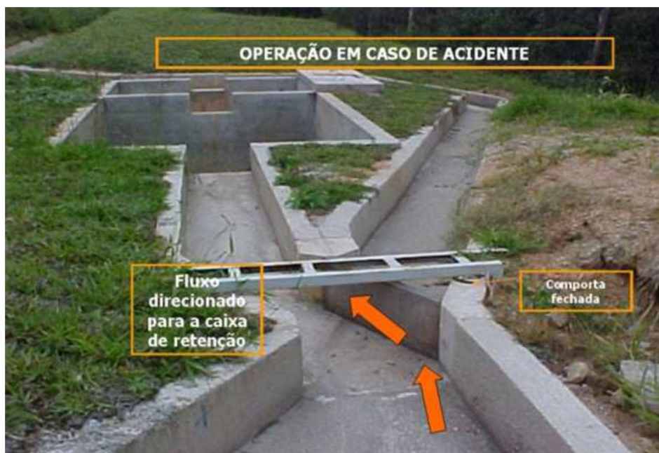
Figura 12. Vista da caixa de retenção difusa em operação, onde o escoamento está direcionado para o compartimento de decantação (fluxo fechado para o corpo hídrico).
