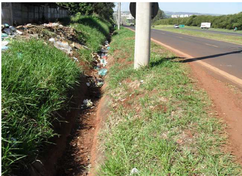
Figura 05. Resíduos Sólidos junto a faixa de domínio e canaletas de drenagem na rodovia SP-66 do km 90 ao km 106
