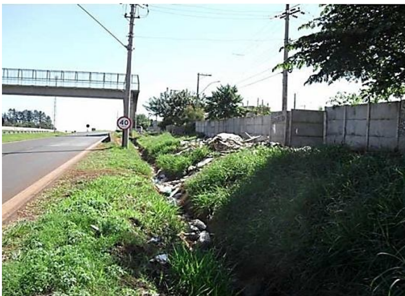
Figura 04. Volume de Resíduos Sólidos junto a faixa de domínio e canaletas de drenagem na rodovia SP 66 km 90 ao km 106
