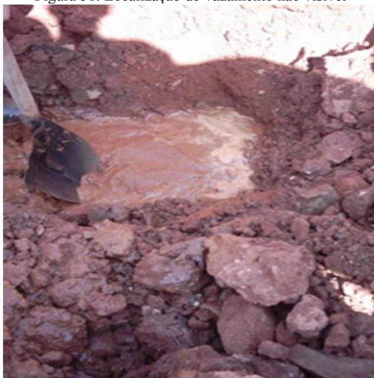
Figura 51. Localização do vazamento não visível
