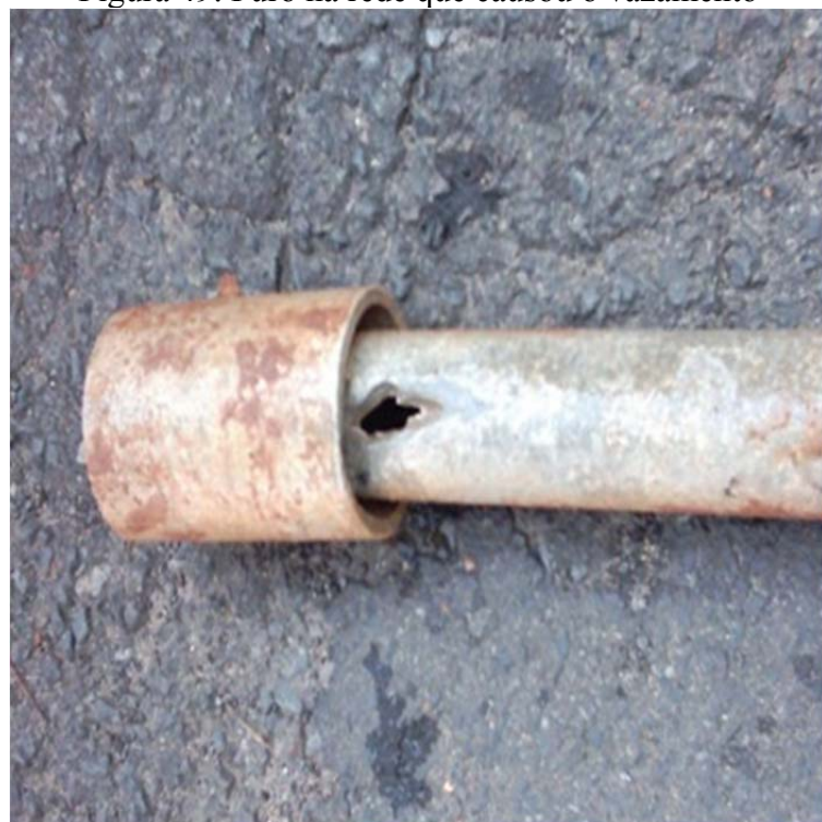
Figura 49. Furo na rede que causou o vazamento
