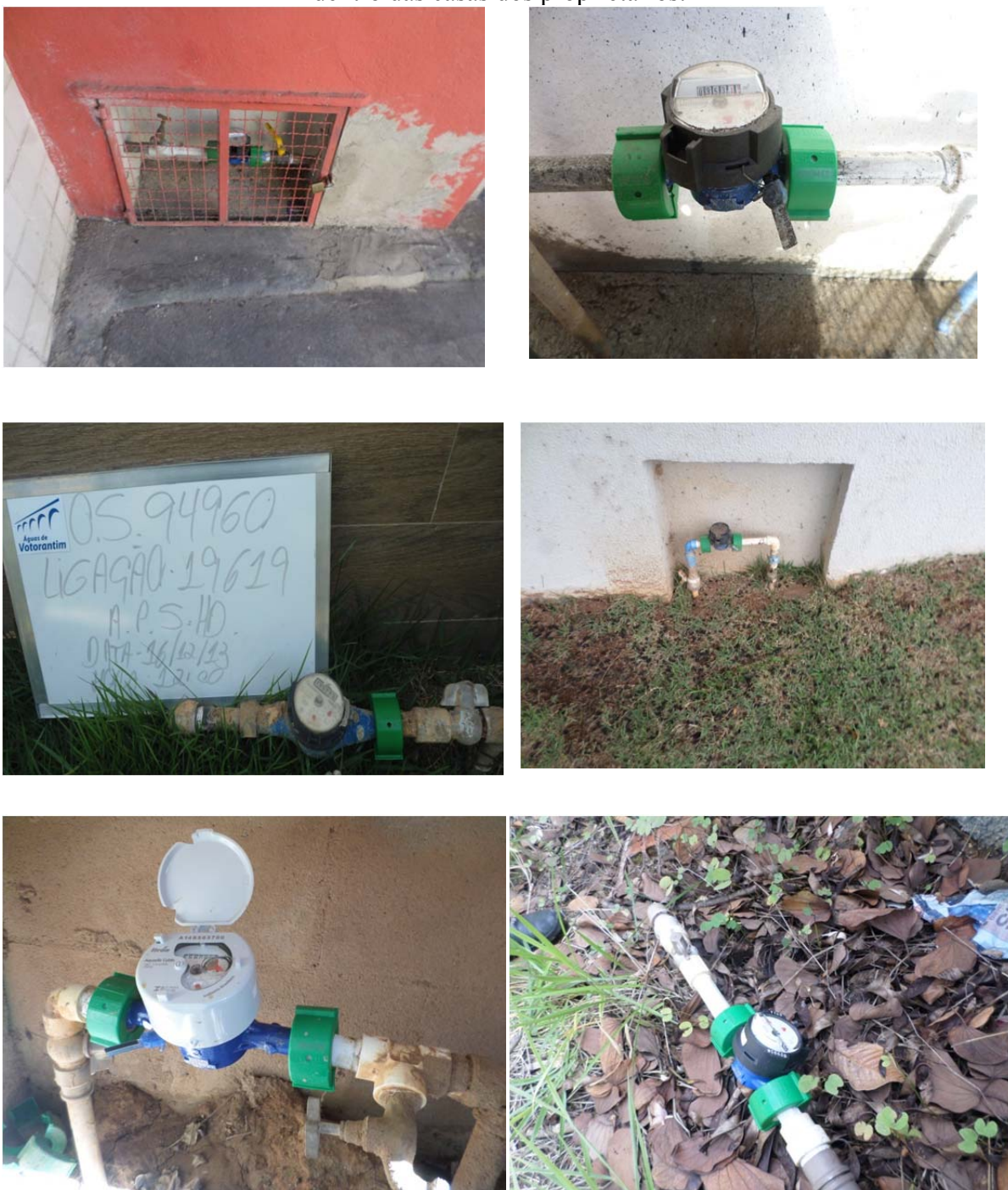
Figura 30. Hidrômetros existentes no sistema de abastecimento de água que estão situados dentro das casas dos proprietários.
