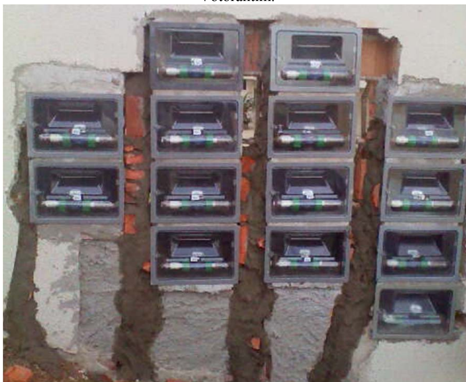
Figura 29. Instalação de caixas de proteção junto aos hidrômetros do município de Votorantim.
