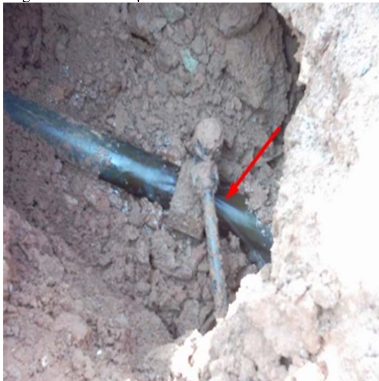
Figura 52. Localização do vazamento no colar de tomada
