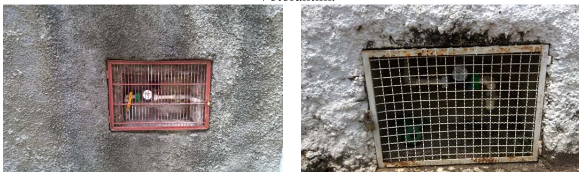
Figura 32. Hidrômetros virados existentes no sistema de abastecimento de água de Votorantim.
