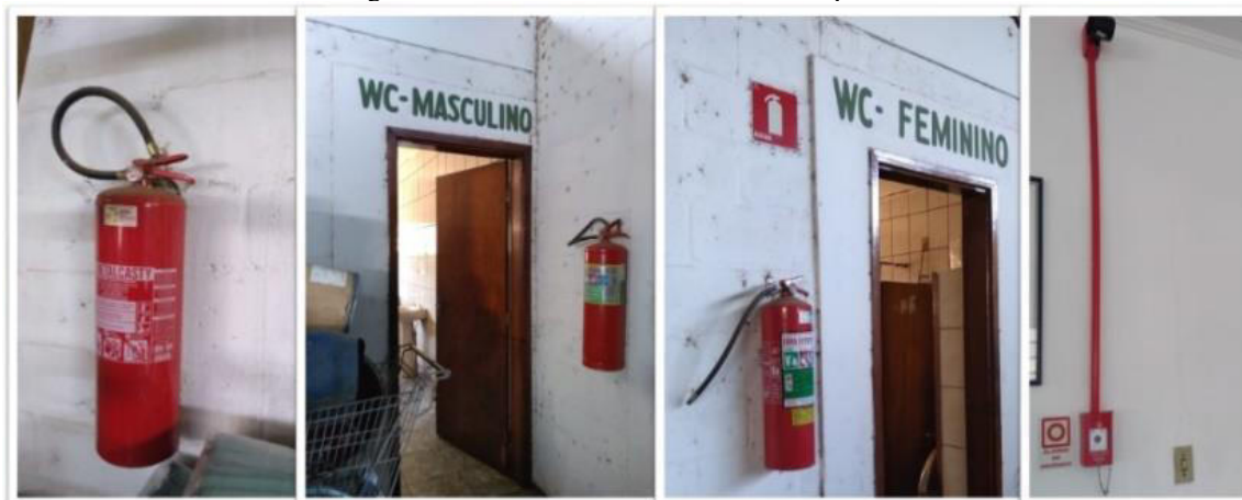
Figura 27 – Extintores de incêndio na cooperativa
