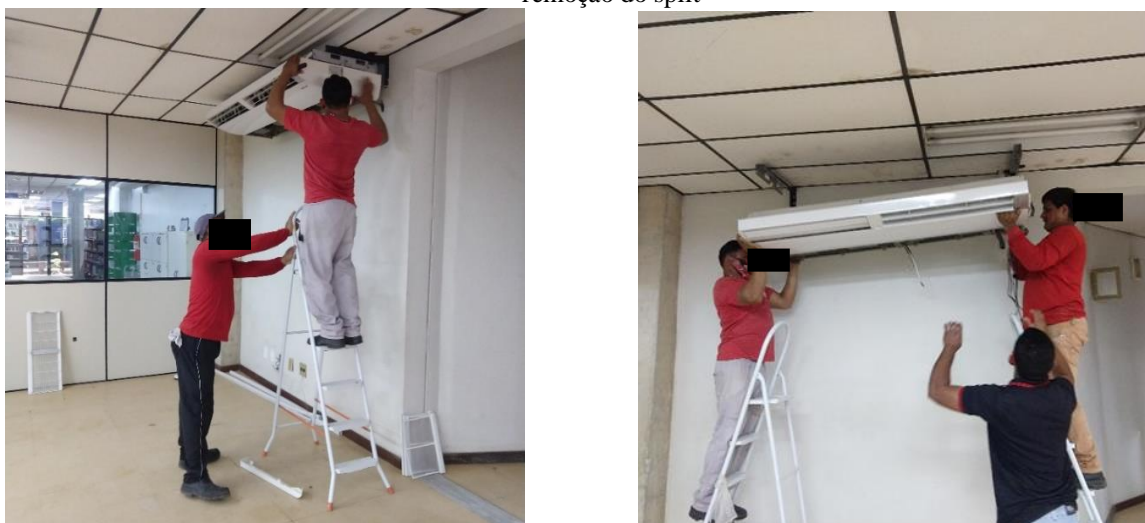
Figura 41 – Retirada do maquinário para a realização da limpeza: (a) remoção das peças laterais do Split; (b) remoção do split
