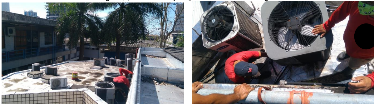
Figura 40 – Trancamento do gás refrigerante na unidade externa: (a) funcionários executando o trancamento de gás; (b) detalhe da operação de trancamento de gás
