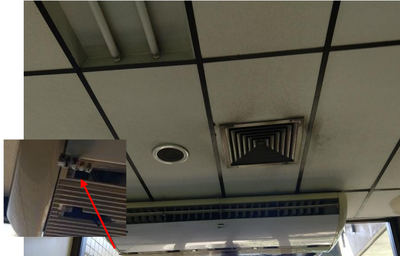
Figura 22 – Detalhe da placa universal do Split 3 localizado no pavimento térreo da Biblioteca
