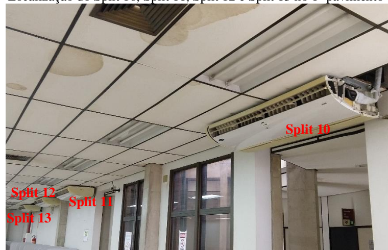
Figura 23 – Localização do Split 10, Split 11, Split 12 e Split 13 no 1º pavimento da Biblioteca
