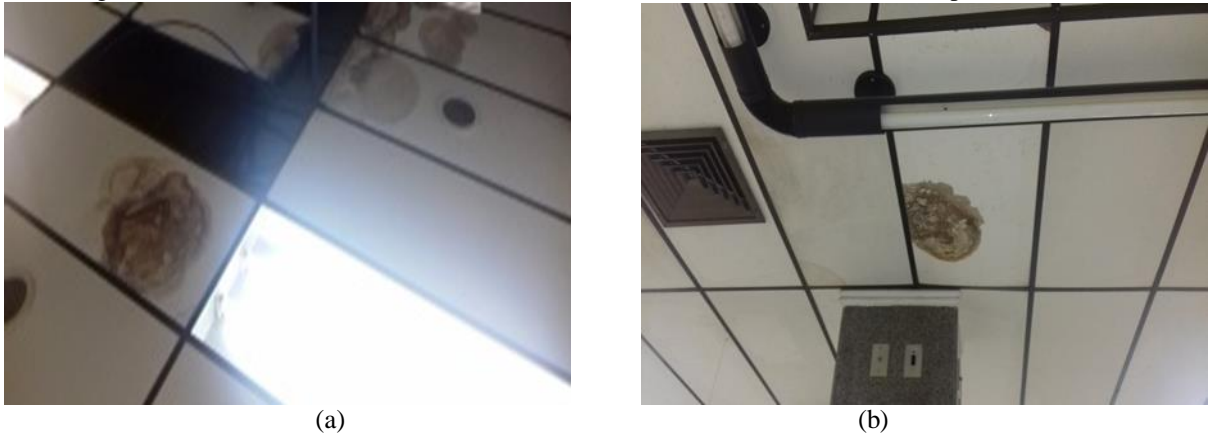
Figura 19 – Colônias de mofo/bolor no forro: (a) no teto do acervo; (b) no teto do pavimento térreo
