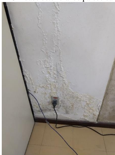
Figura 34 – Umidade deteriorando parede da Biblioteca
