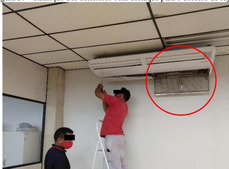
Figura 37 – Remoção dos defletores com destaque para o excesso de sujeira
