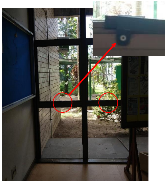
Figura 16 – Detalhe da janela no pavimento térreo presa por rebite
