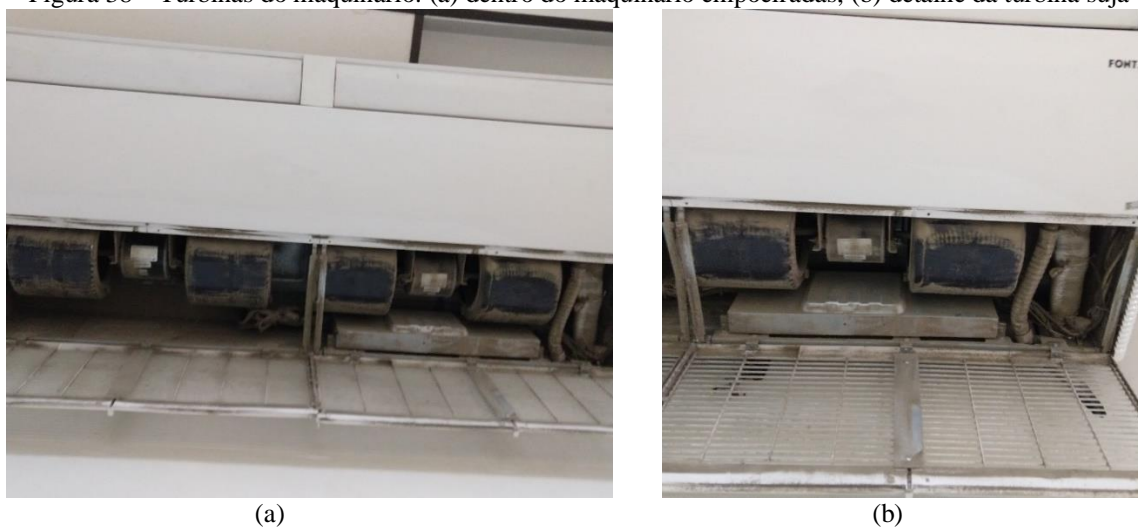
Figura 38 – Turbinas do maquinário: (a) dentro do maquinário empoeiradas; (b) detalhe da turbina suja
