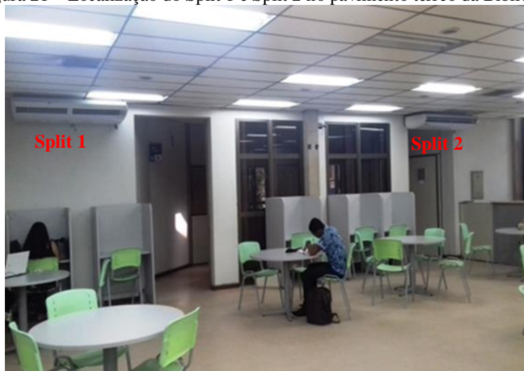
Figura 21 – Localização do Split 1 e Split 2 no pavimento térreo da Biblioteca
