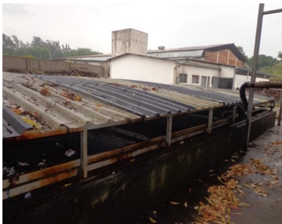
Figura 77– Leito de secagem do lodo, impermeabilizado e coberto
