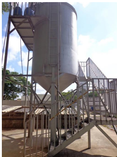
Figura 62 – Tanque-reator utilizado para tratamento do efluente líquido
