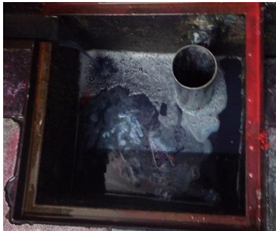
Figura 60 – Entrada do efluente líquido na área de lavagem das telas
