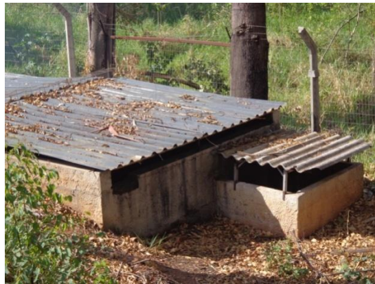
Figura 61 – Caixa receptora do efluente líquido
