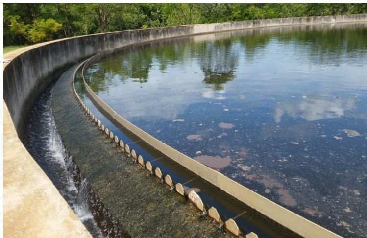
Figura 5 – Local de coleta do efluente tratado na saída do sedimentador secundário da ETE
