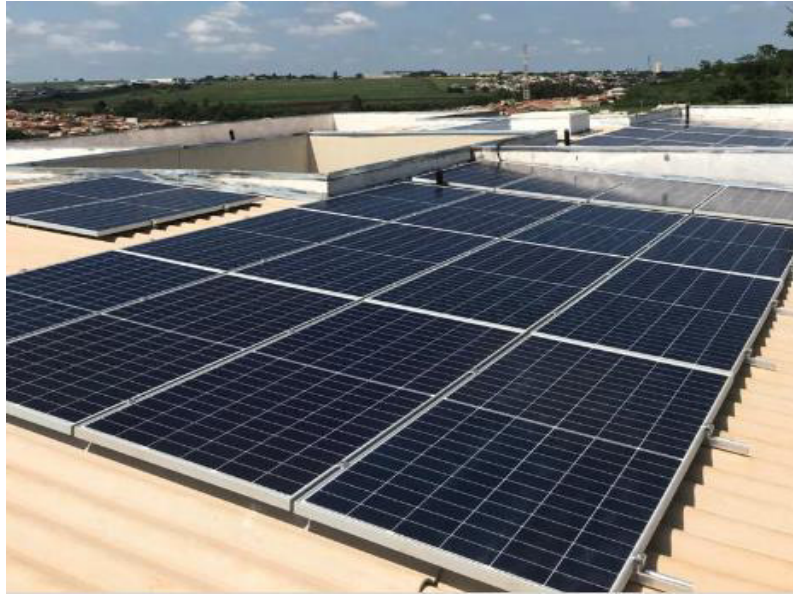
Figura 14. Placas para captação de energia solar.
